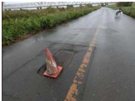
※マンホールが沈んで通行不能な箇所
